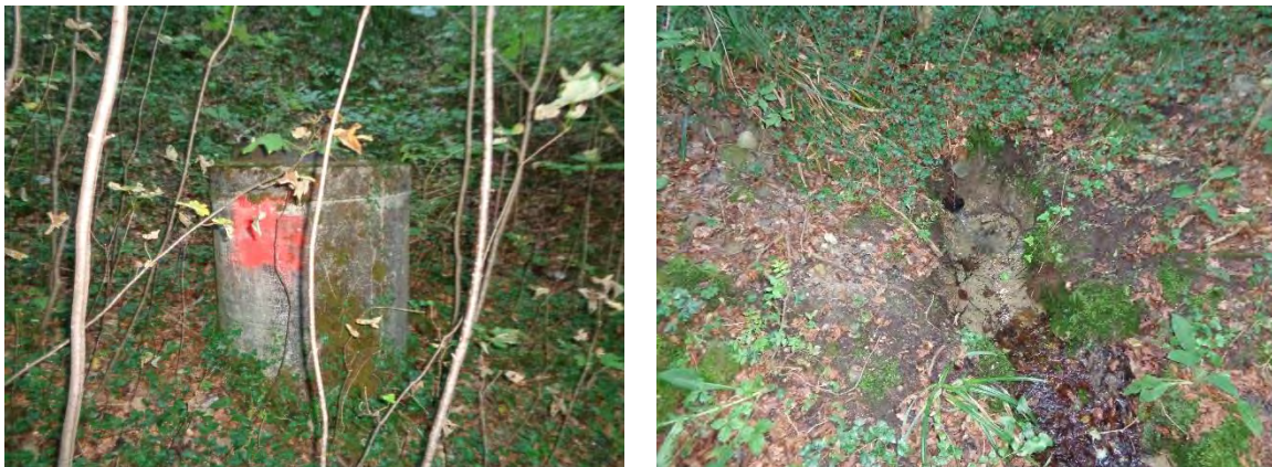
Abb. 3.32 und 3.33: Quellschacht Waldquelle (Fotos L&H 9.9.2016)
