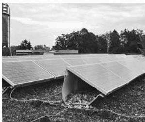
Fotovoltaikanlage auf dem Werkhof
