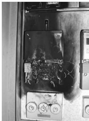
Zählerbrand nach dem Blitzschlag
